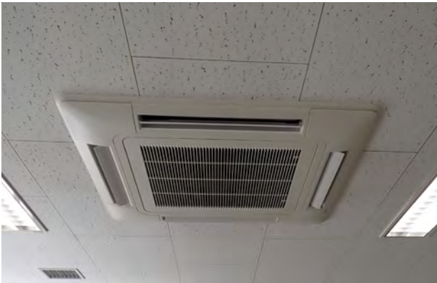
【写真 2】高効率空調機 室内機
