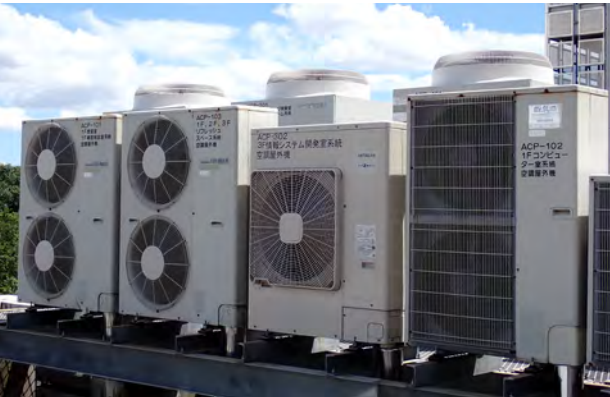
【写真 1】高効率空調機 室外機
