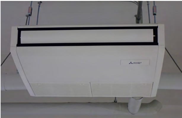
【写真 2】高効率空調機 室内機
