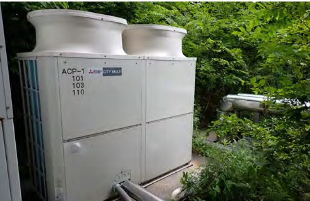
【写真 1】高効率空調機 室外機
